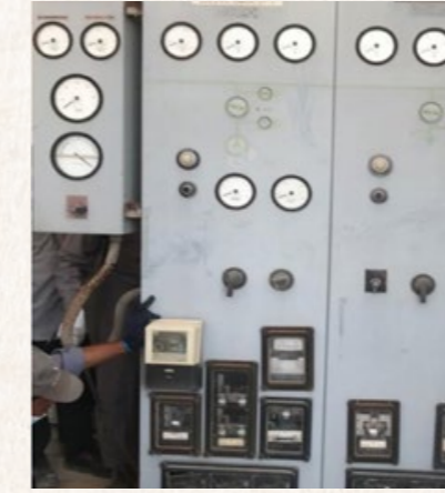
33kv Control Panel لوحة التحكم جهد 33 ك.ف. استخدمت هذه اللوحة في المحطة C لإنتاج الطاقة في منطقة الحضيبة.
