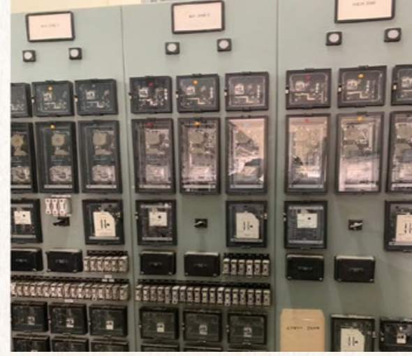
لوحة الحماية الكهربائية 33 كيلو فولت 33kV Relay Panel
